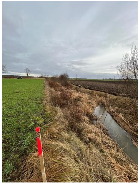
Attēls Nr. 35. Skats augšup pirms darbu veikšanas pik 03/00. Attēla autors - SIA “Progressive Systems”, 2024.
